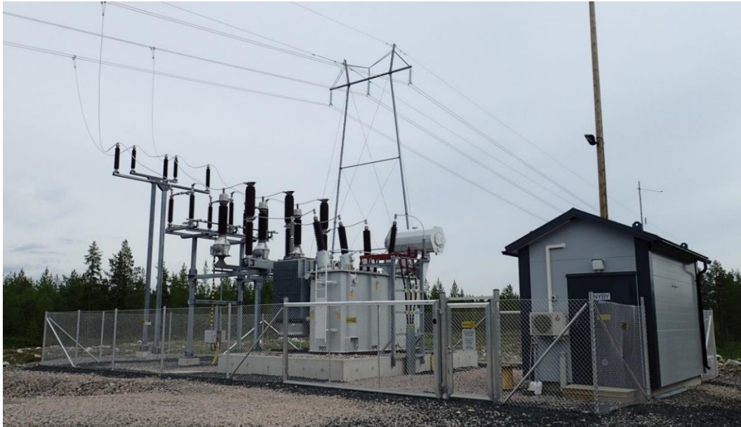
Kuva 5-8. Esimerkki tuulivoimapuiston sähköasemasta (Kuva: FCG).
